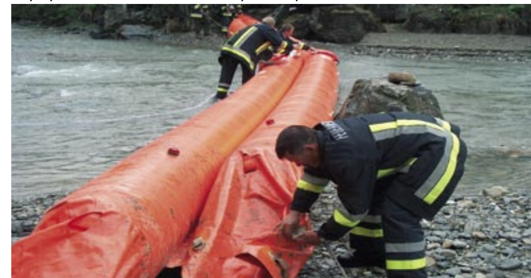
Les pompiers de Vals GR testent des mesures temporaires de protection contre les crues.
