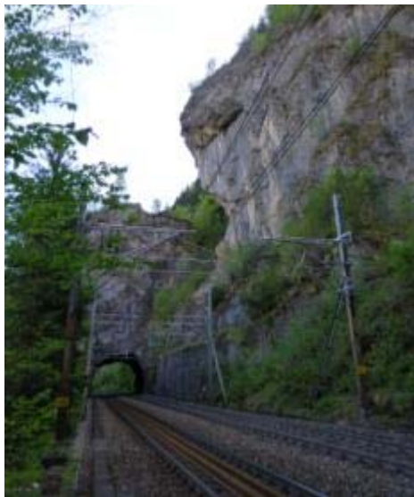
Figure 12 : La rampe nord de la ligne du BLS est principalement menacée par des processus de chute entre Frutigen et Kandersteg.
