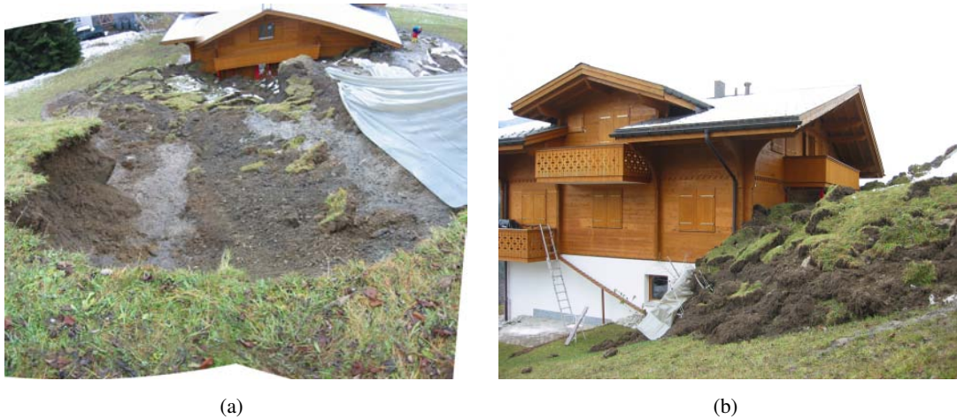
Abbildung 1.3: Spontane Rotationsrutschung: Im Transit- und Auslaufbereich konnte die Hauswand des neuen Gebäudes dem Staudruck nur bedingt Stand halten. Ein Teil der Gebäudemauer wurde eingedrückt. Foto: GEOTEST AG (a,b).
