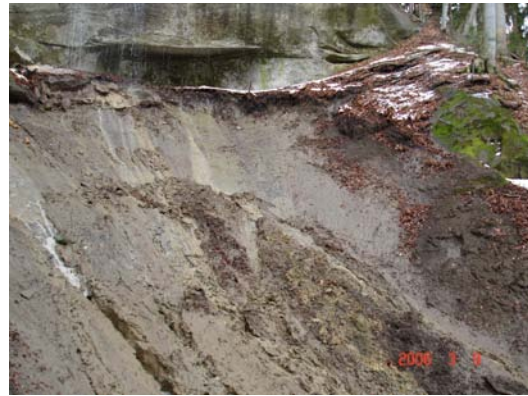
(b) Detail der Anrissstelle, abgerutschtes Lockermaterial auf dem Fels.
