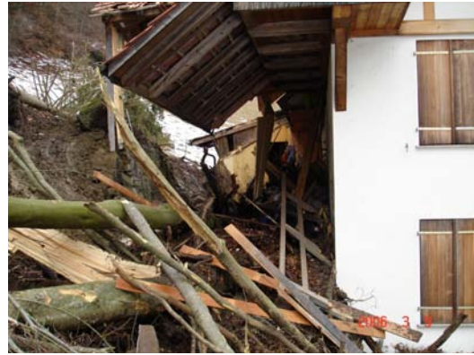
(d) Zerstörung der Rückwand.
