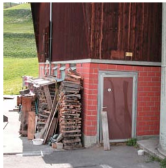
(b) Gebäude auf Scherzone. Das Gebäude wird diagonal zerrissen, die Struktur kann den Scherkräften nicht standhalten. Seitenmauer und Decke werden gegenseitig verschoben, die Türe kann nicht mehr geschlossen werden.
