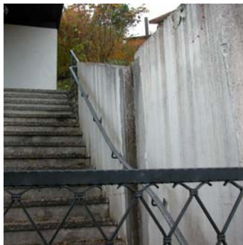
(a) Stützmauer im Bereich mit differentiellen Bewegungen. Die Mauer wird zerrissen und verschoben. Der Handlauf aus Stahl wird duktil verbogen (Verschiebung ca. 0.5 cm / Jahr).
